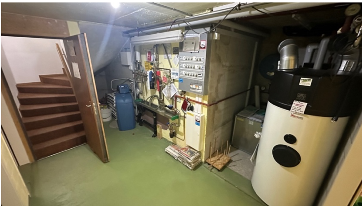
Keller Korridor / Technik
